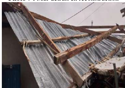
Photo 9 : Toiture endommagée d'une maison
