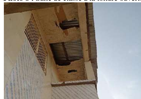
Photo 10 : Plafond endommagé d'une maison
